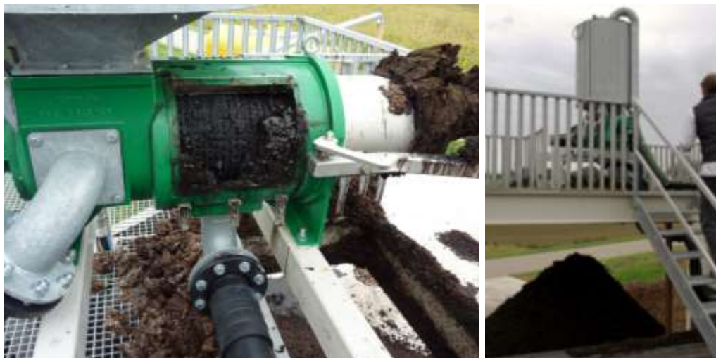
Figur 1.11. Avvattningsanläggning för rötrest (Foto: David Ljungberg).
